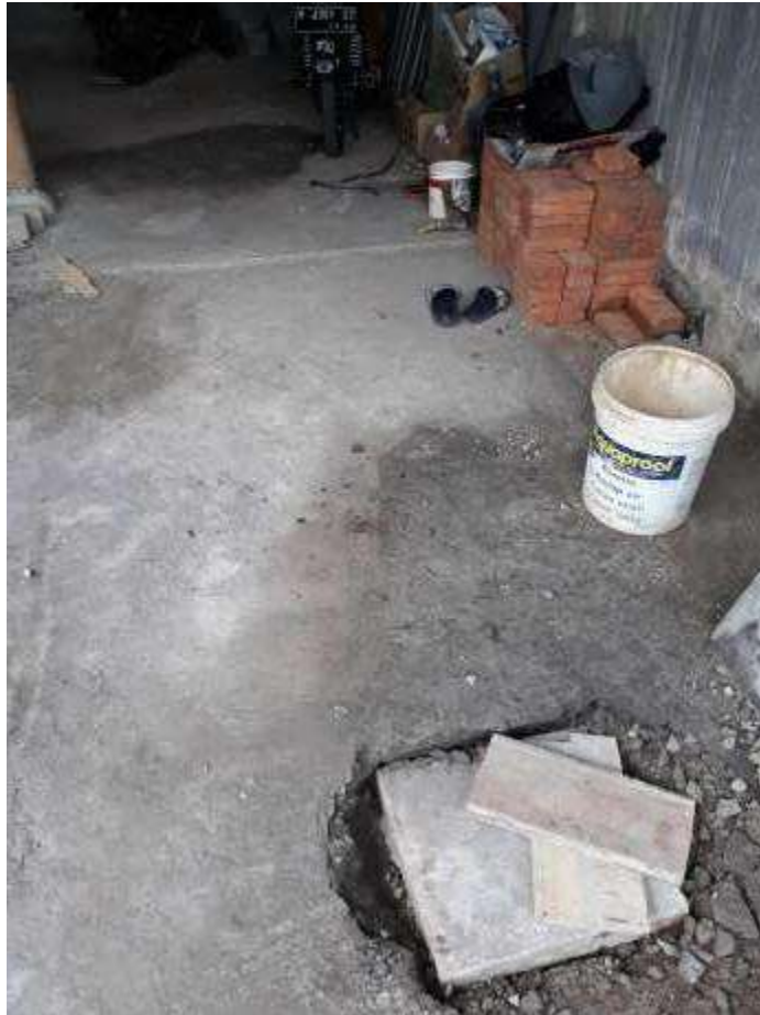
Gambar 9: Tutup Buist Beton yang Paling Depan, pada Carport (Sumber: Dokumentasi Pribadi)
