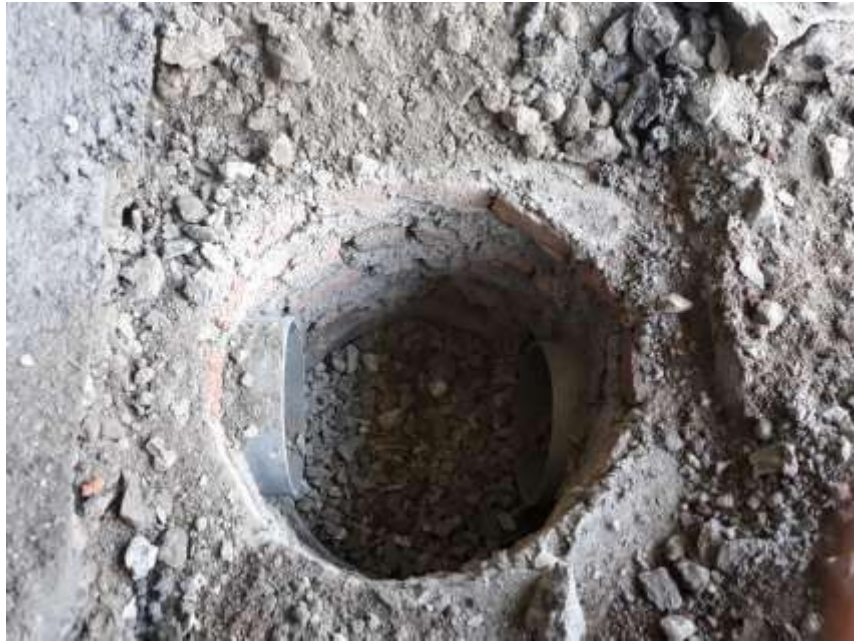
Gambar 7: Buist Beton Sebagai Resapan Air Hujan (Sumber: Dokumentasi Pribadi)
